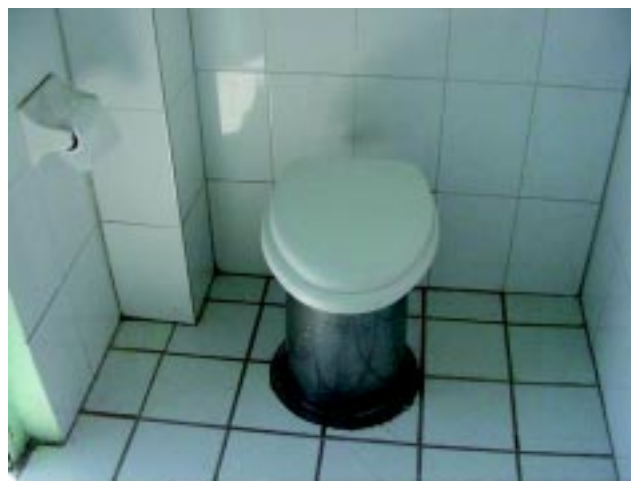
Figura 2 Las letrinas deben estar construidas con materiales fáciles de limpiar como los que se observan.
