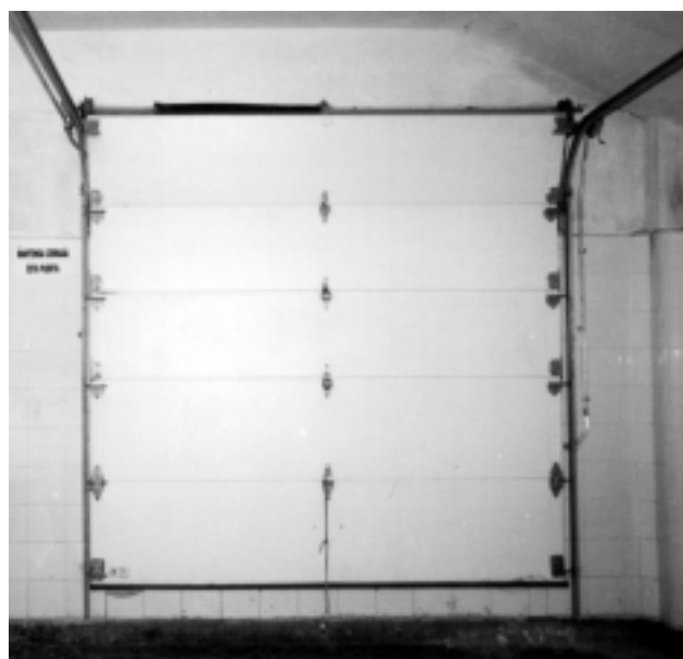
Figura 4.3 Puerta exterior de una planta procesadora de productos marinos y acuícolas que cierra completamente para impedir la entrada de insectos y polvo.
